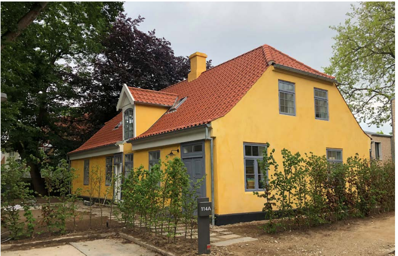
Falkonergården efter restaureringen. Restaureret 2019-2023. Farvesætningen følger klassicismens farver, gulddokker kalkfarve og vinduer, døre og skodder i en kold grå. Billedet af taget fra modsatte hjørne i forhold til "før" foto øverst. Foto: Frederiksberg Kommune.
