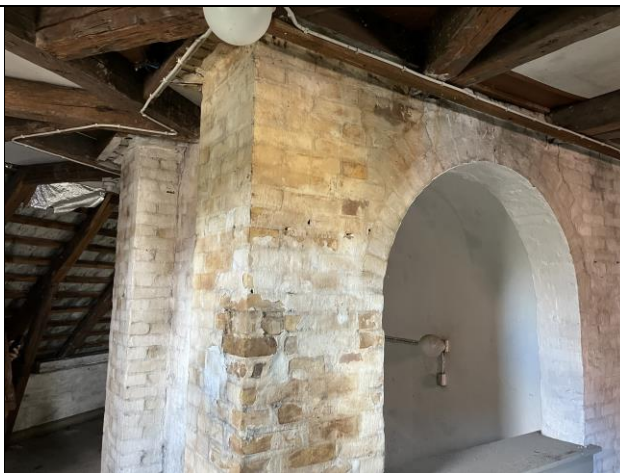
Foto 6 – Synlige påvirkninger efter opfugtninger på opmurede konstruktion i center af bygning
