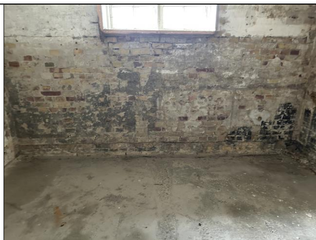
Foto 10 – Synlige tegn på kælderydervægge af opstigende grundfugt/indtrængning af overfladevand
