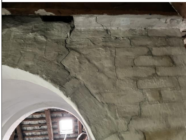
Foto 7 – Kraftige revnedannelser på opmurede konstruktion i center af bygning
