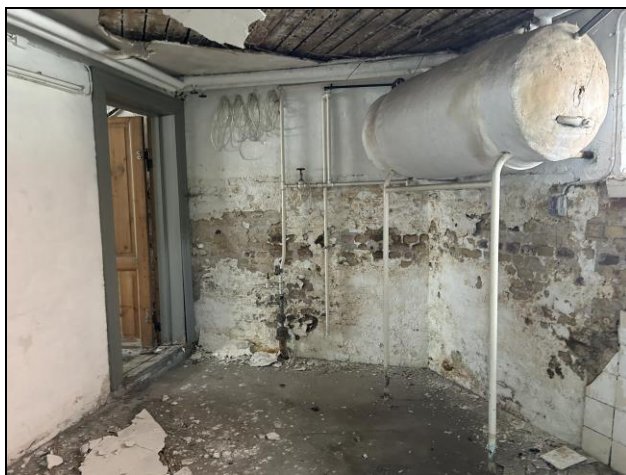
Foto 9 – Synlige tegn på kælderydervægge af opstigende grundfugt/indtrængning af overfladevand
