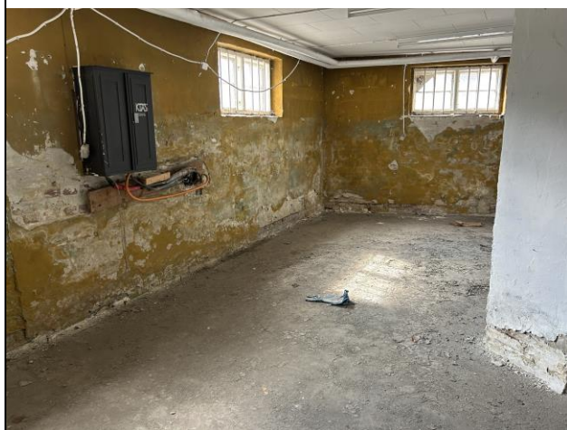
Foto 11 – Synlige tegn på kælderydervægge af opstigende grundfugt/indtrængning af overfladevand
