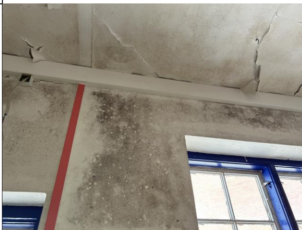
Foto 8 – Synlige aftegninger af skimmelsvamp på indvendige overflader i stueetage.
